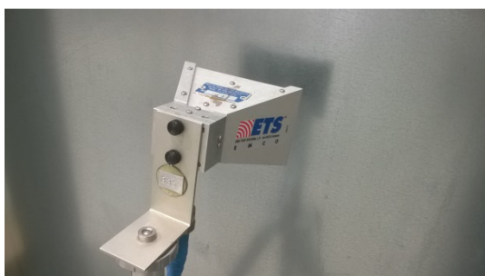
Figura 2. Antena direcionada a uma parede metálica
